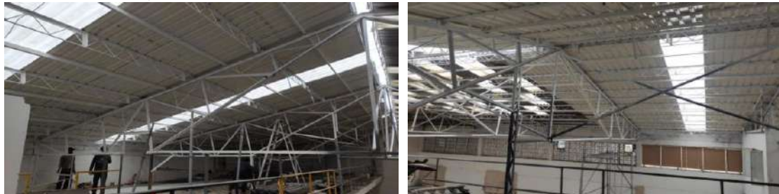
Avance en mantenimiento a estructura metálica y cambio cubierta en CTP nuevo.
