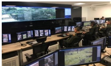
Centro de Monitoreo Existente Modernizado COSEC 3 KENNEDY Dirección: Transv 78 K Con Calle 41 D Sur Creado con el contrato 877-2017
