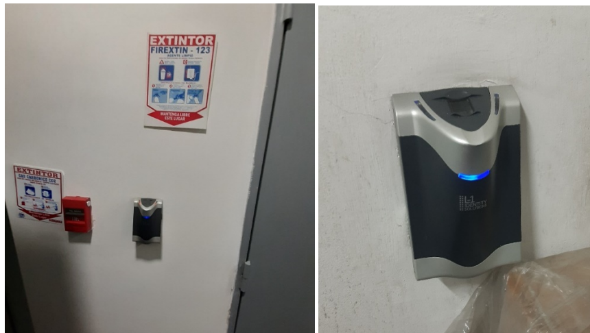
Imagen 19, Sistema huellero electrónico de entrada y salida del DC Ciudad Bolívar dañados
