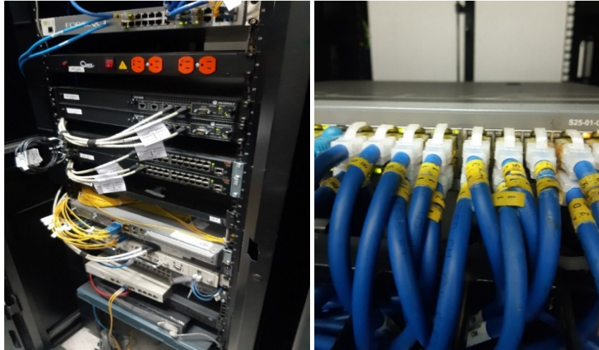
Imagen 16, Equipos de red sin diagramación y puertos de los switch sin registro de utilizados y disponibles en el DC de Ciudad Bolívar.
