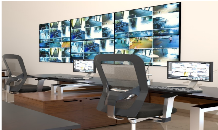
Imagen 30, sala de monitoreo con un mínimo de pantallas de control, fuente Internet
