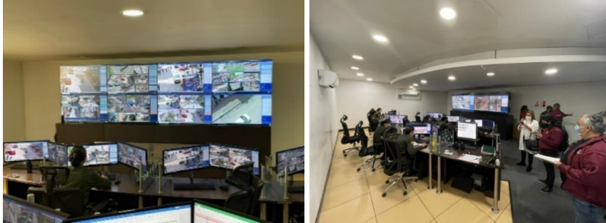
Imagen 20, Salas de monitoreo de cámaras Cosec Puente Aranda y Ciudad Bolívar.
