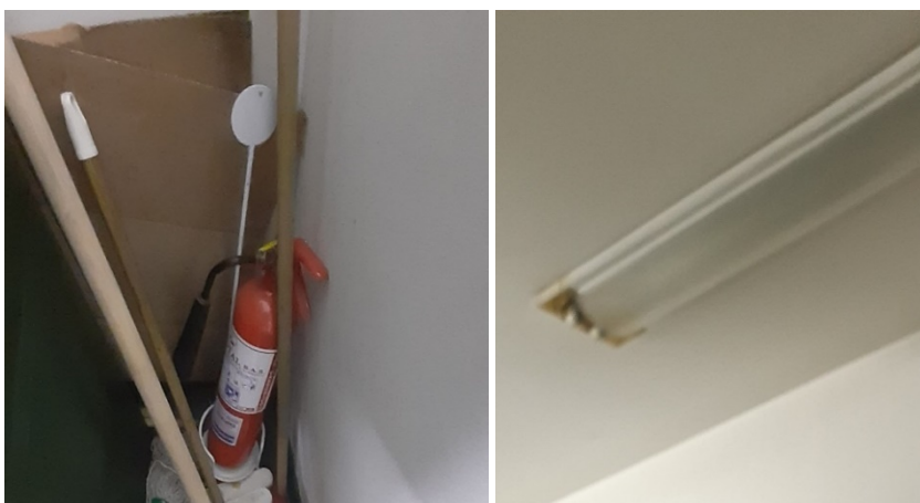
Imagen 12, Extintor de fuego a fuera del DC de Ciudad Bolívar y tubos balastos de iluminación dañados
