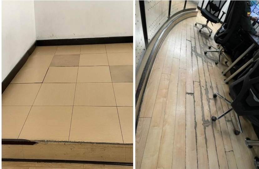
Imagen 22, piso firme y falsos deteriorados del Centro de Monitoreo Puente Aranda
