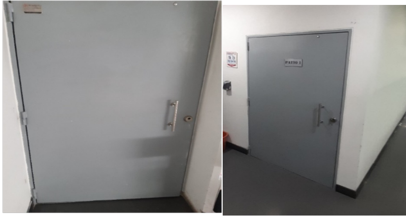
Imagen 7, Puertas sin señalización de los DC de Puente Aranda y Ciudad Bolívar
