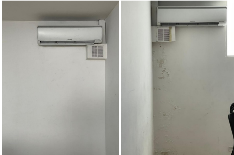
Imagen 23, aire acondicionado fuera de servicio, filtración constante de agua y humedad en la pared del Cosec de Puente Aranda.
