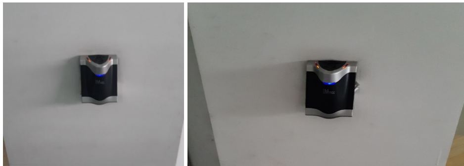
Imagen 18, Sistema huellero electrónico de entrada y salida del DC Puente Aranda dañados.
