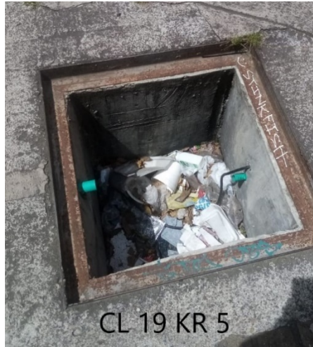
Imagen 4 caja al piso sin mantenimiento, con escombros
