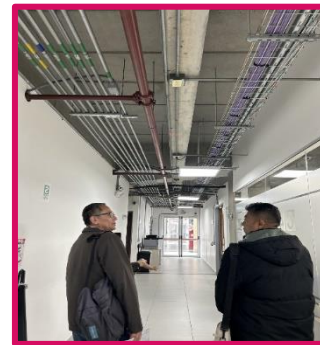
Canaletas instaladas de cableado estructurado
