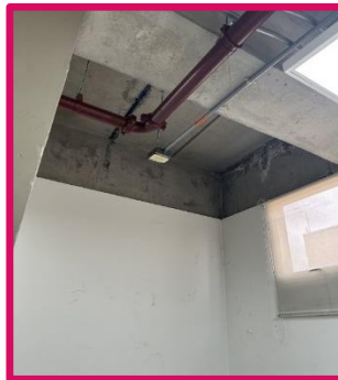
Humedades recurrentes en concretos
