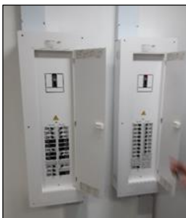
Imagen No.22. Tableros eléctricos red regulada y no regulada sin diagramación - Cárcel Distrital
