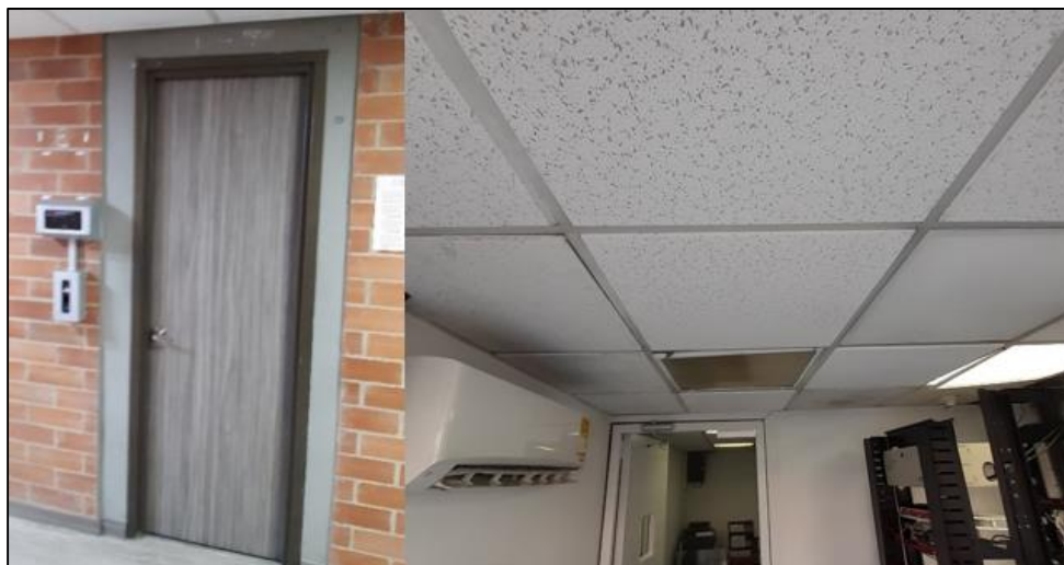
Imagen No.19. Puerta de entrada y al interior del Data Center sin cámaras - Cárcel Distrital
