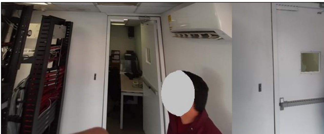
Imagen No.20. Entrada y al interior del Data Center sin señalización - Cárcel Distrital
