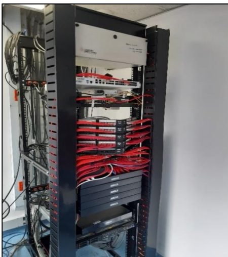
Imagen No.23. Rack con patch paneles y switches sin diagramación - Cárcel Distrital
