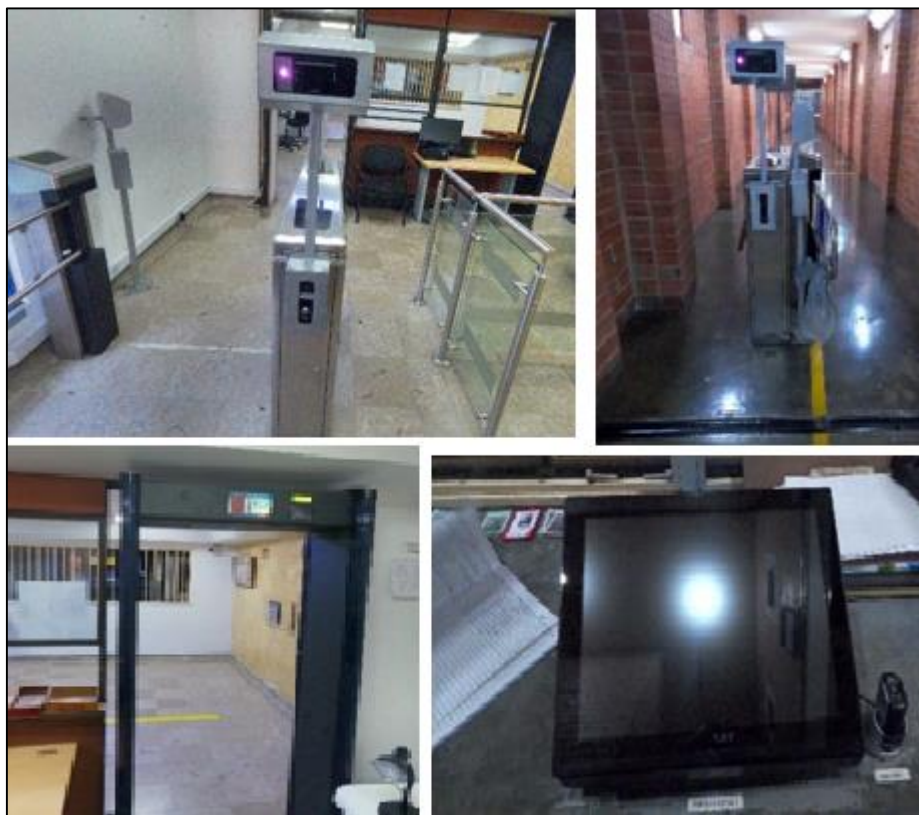
Imagen No.31. Sistema Biométrico y control de puertas fuera de servicio – Cárcel Distrital
