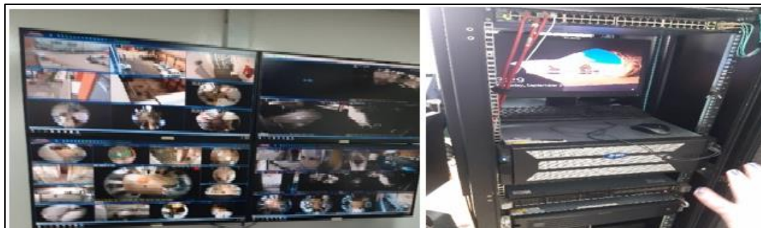
Imagen No.31. Rack con dispositivos de comunicación de cámaras y centro de monitoreo en un mismo espacio
