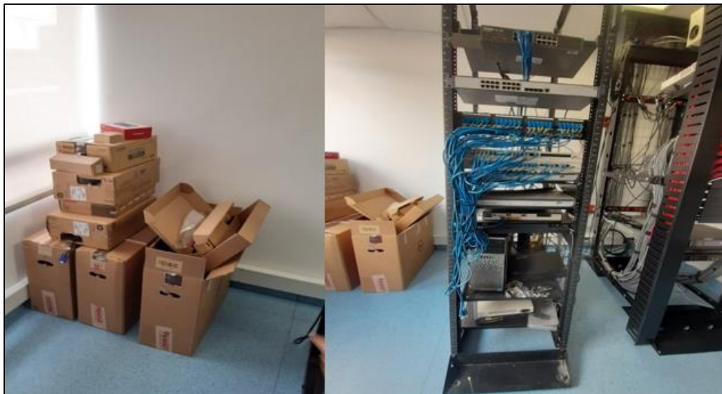
Imagen No.21. Cajas con equipos de cómputo al interior del Data Center - Cárcel Distrital
