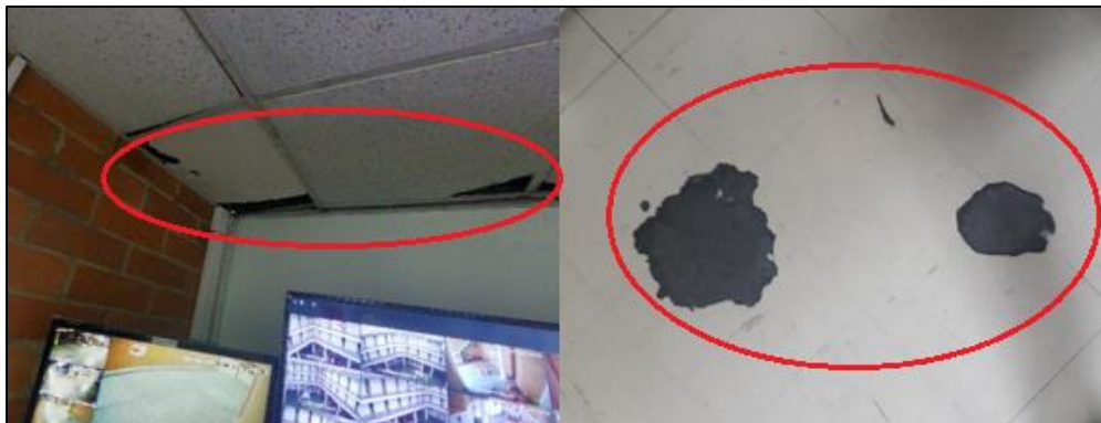
Imagen No.32. Deterioro techo falso y pisos centro de monitoreo SVV – Cárcel Distrital
