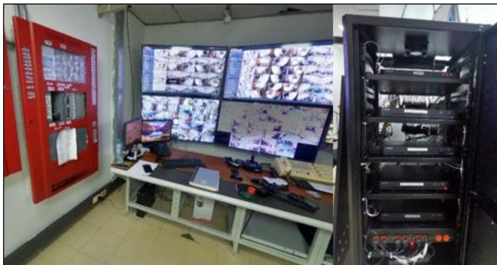
Imagen No.26. Tablero eléctrico, rack con DVRs y centro de monitoreo en un mismo espacio
