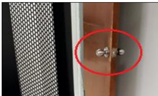
Imagen No.30. Puerta de entrada al centro de monitoreo sin control electrónico - acceso con huella dactilar
