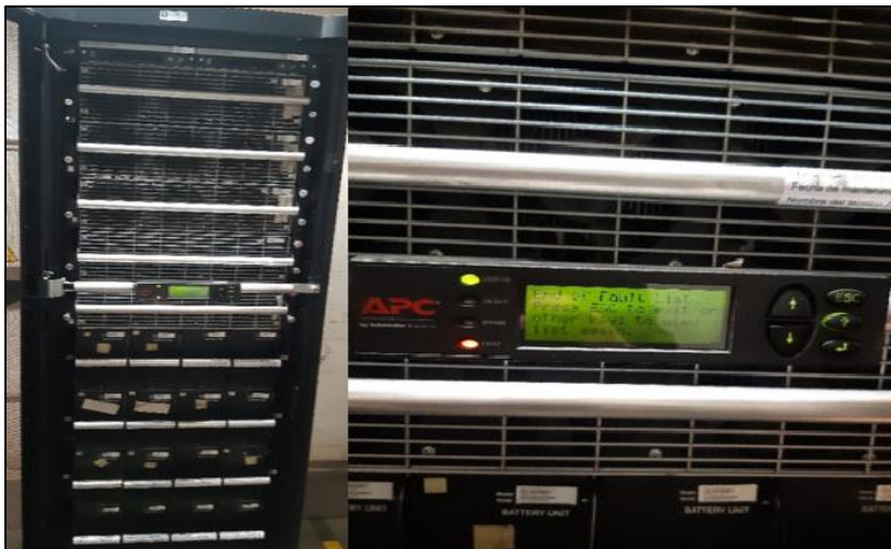
Imagen No.25. UPS marca APC con testigo encendido anunciando el daño de 2 módulos - Cárcel Distrital
