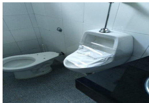
Imagen No. 17 Baño defectuoso
