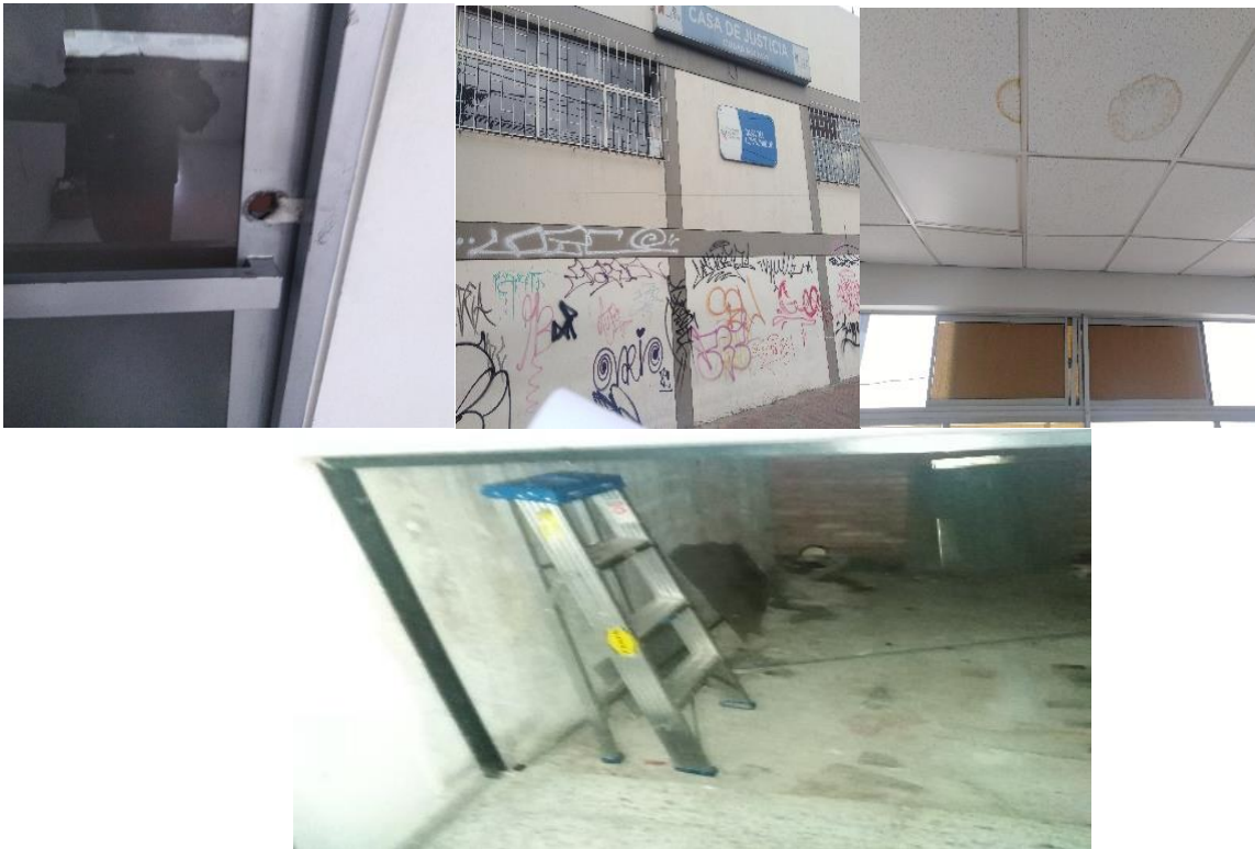
Imagen No. 4 puerta, fachada, humedad y sótano
