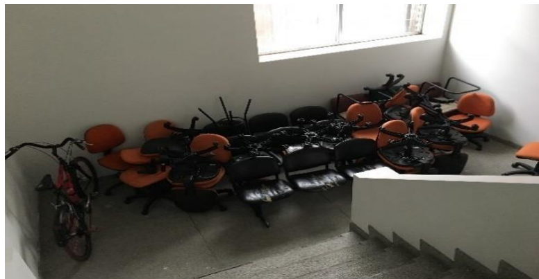
Imagen 6 No. paso obstaculizado salida de emergencia
