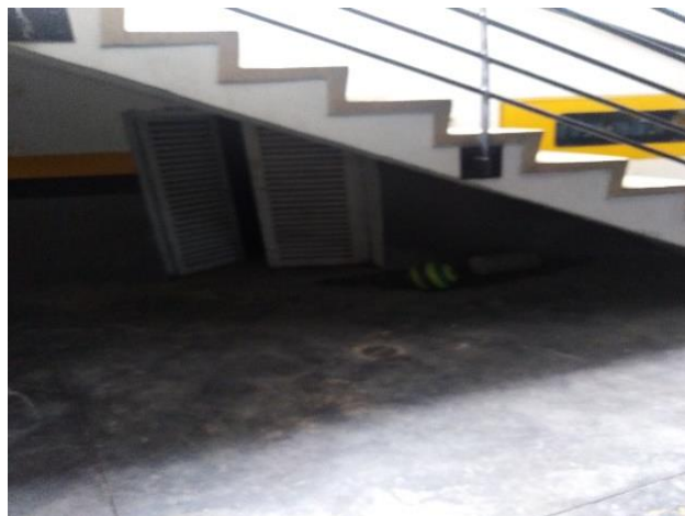
Imagen No. 21 Humedad sótano
