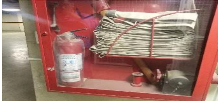
Imagen No. 24 Extintores Caja Incendios
