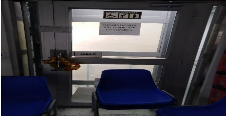
Imagen No. 1 ascensor fuera de operación
