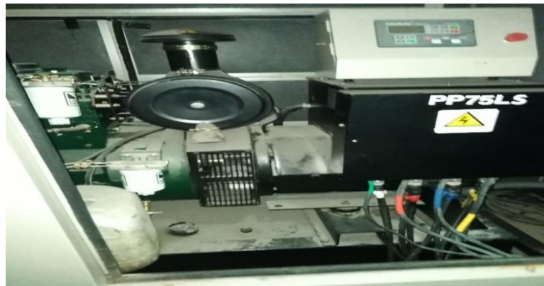
Imagen No. 15 Planta eléctrica
