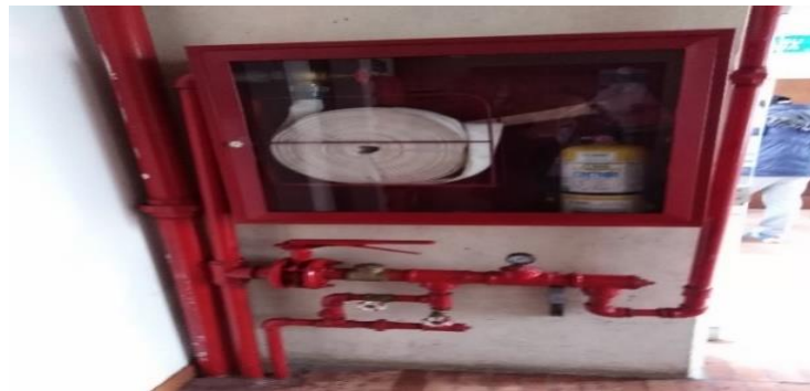
Imagen No. 16 Sistema contra incendios
