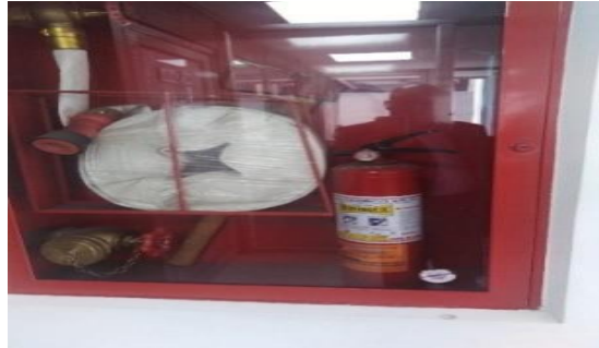
Imagen No. 26 Extintor vencido
