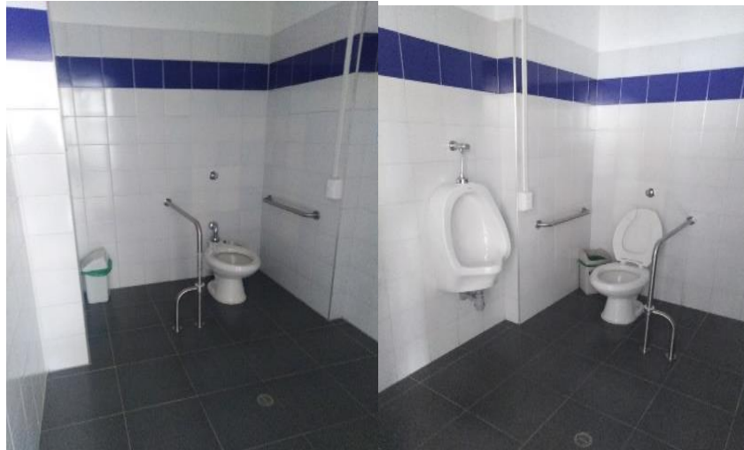
Imagen No. 20 Baños no ventilados
