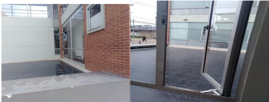
Imagen No. 27. Inseguridad ventana abierta piso 1°
