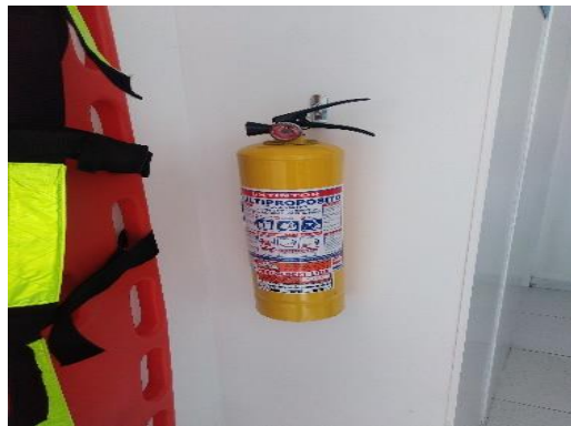
Imagen No. 25 Señalización extintores
