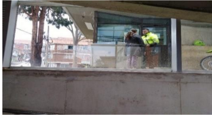
Imagen No. 14 Humedad en la ventana
