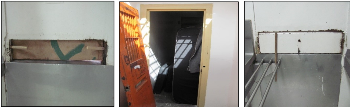
Imágenes 5: Daños en ornamentación metálica en el área de reparto de alimentos pasillo central de pabellones
