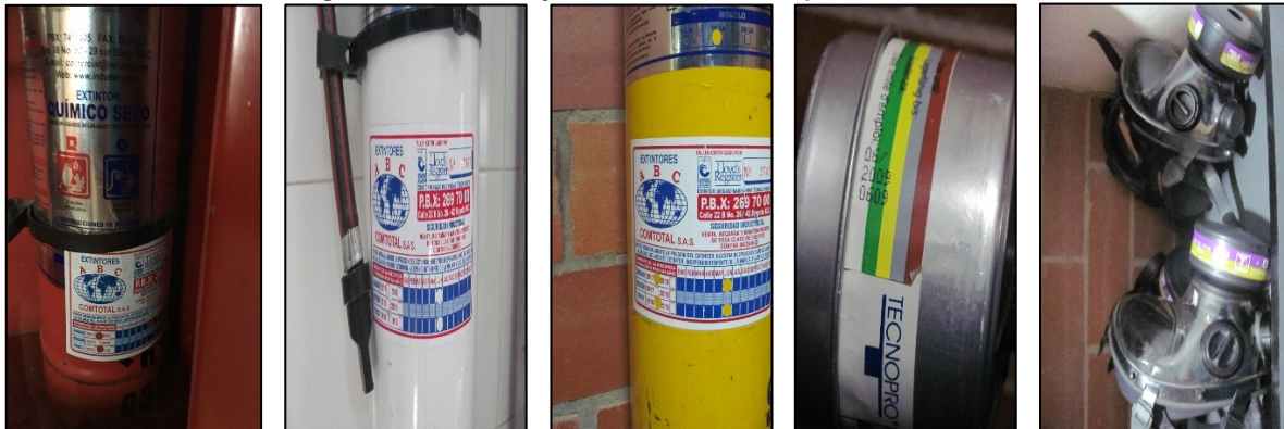
Imágenes 7: Extintores y filtros de máscaras expirados 05/09/2018
