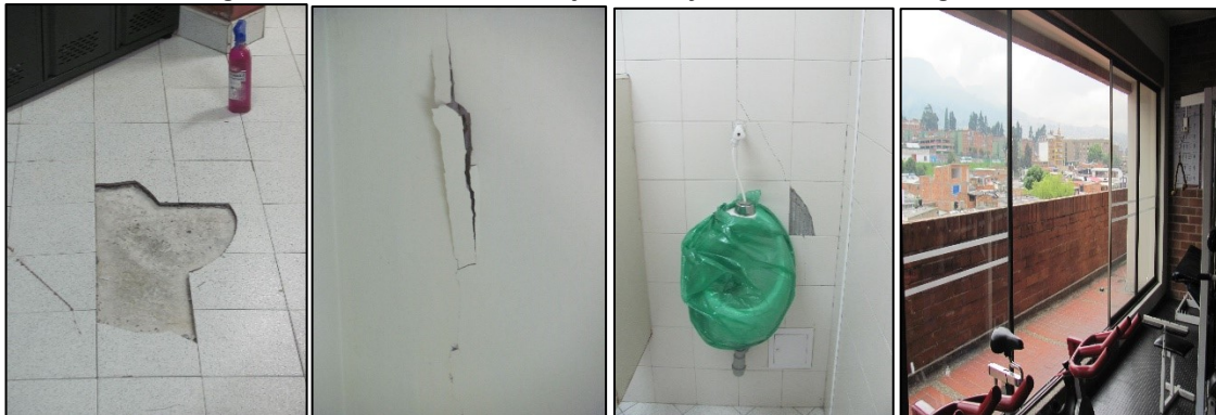
Imágenes 6: Daños en baños de alojamientos y falta de vidrios en el gimnasio.
