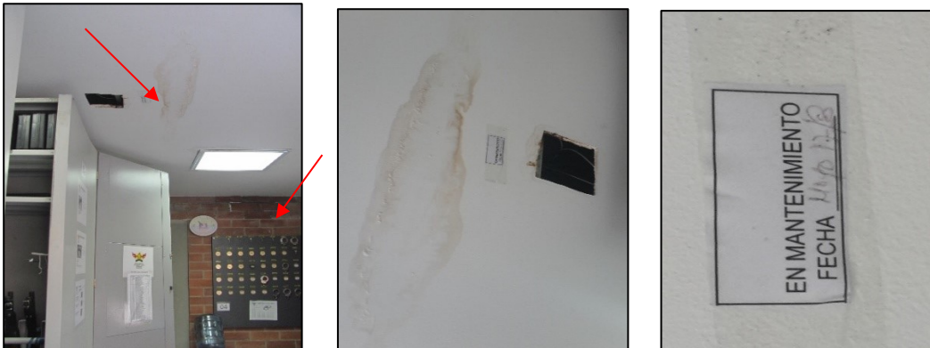
Imágenes 9: Daños en cielo raso y muros por humedad.05/09/2018
