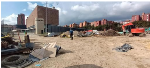
Imagen No 6: Zona de cesión, pendiente inicio de obras por falta de aprobación de diseños en IDU y ENEL
