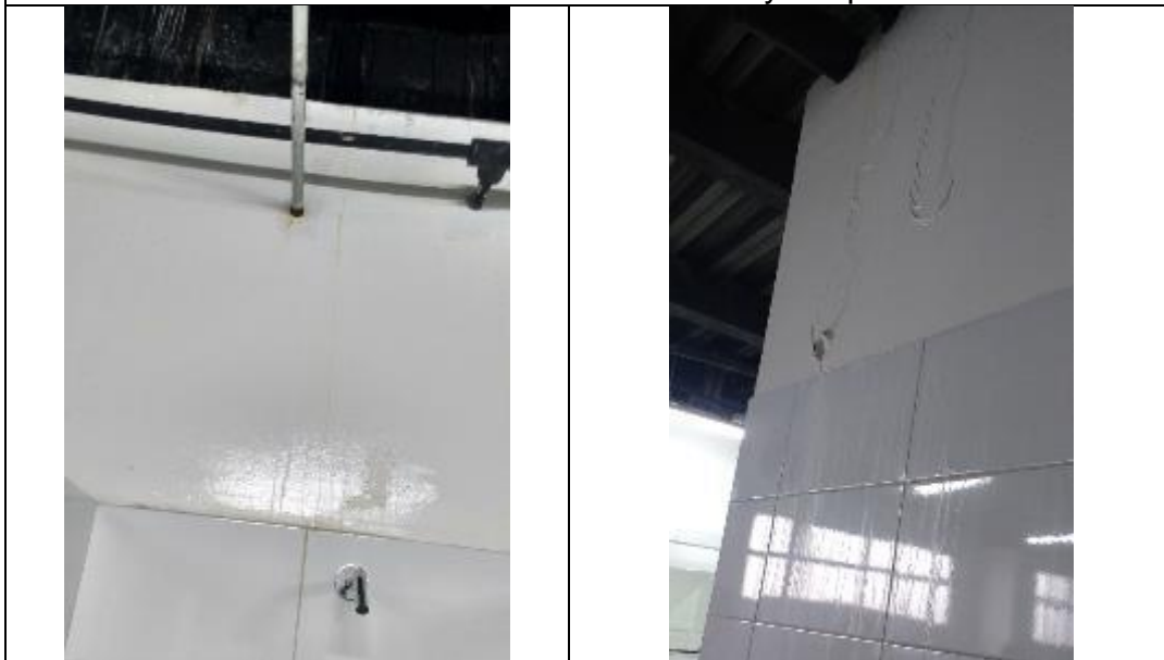
Humedad y goteras en todos los baños de la edificación.
