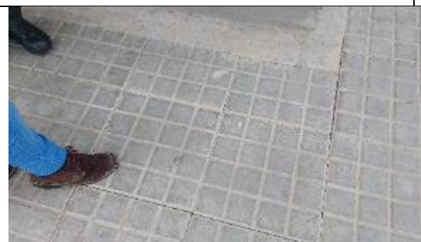
Foto No. 5: un gran porcentaje de las tabletas de concreto instaladas alrededor del CAI se encuentran sueltas, lo que demuestran deficiencias en el proceso constructivo y en la supervisión durante la ejecución y recibo de las obras.
