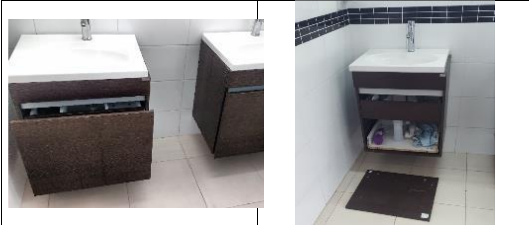
Cajones de los gabinetes no cierran y otros daños
