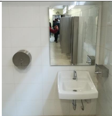
Foto No. 3 Adecuación baños para personas con movilidad reducida : protector de papel higiénico en acero inoxidable, espejo flotante, lavamanos de colgar, dispensador horizontal en acero inoxidable para jabón.
