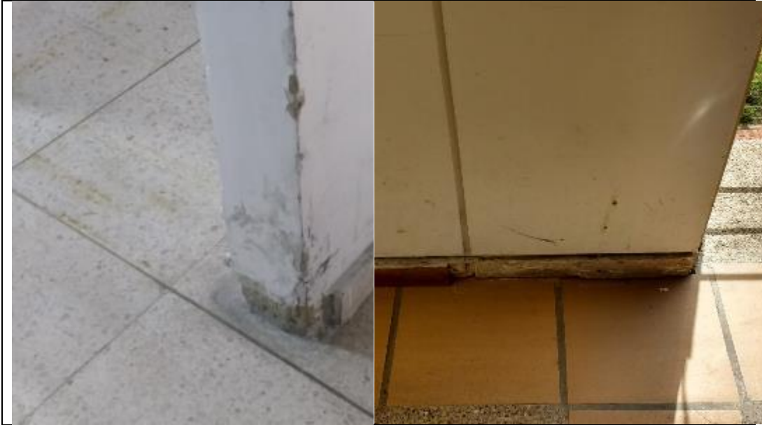
Desprendimiento de guardaescobas
