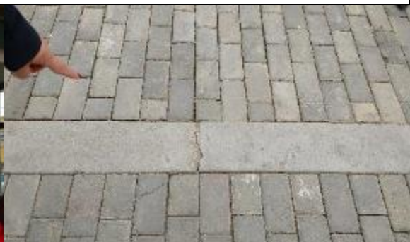
Foto No. 4: algunos de los adoquines de concreto se encuentran fracturados, en algunos sectores no tienen el sello de área y en otros el sello de arena es deficiente.
