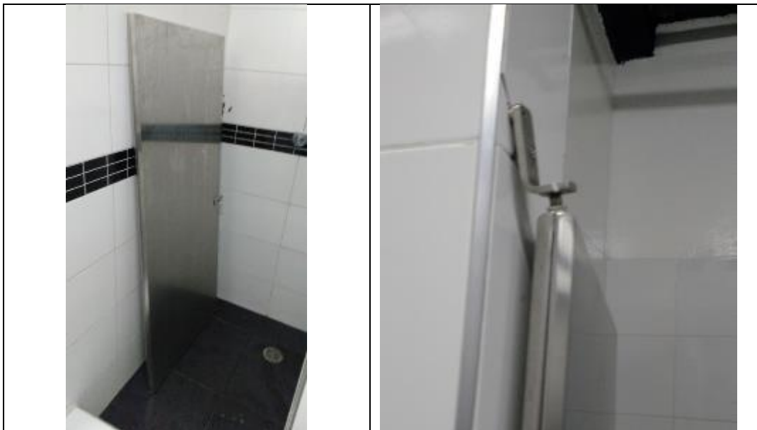
Puertas de las duchas en mal estado y desprendidas
