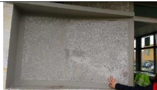
Foto No. 3: los terminados en concreto de la fachada lateral son deficientes.
