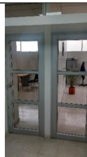
Foto No. 2 Adecuación de tres oficinas en el segundo piso, que incluye división de espacios con muros en dry wall, instalación de baldosas en granito, instalación de luminarias, puertas y ventanas en aluminio, entre otras actividades.
