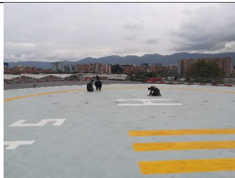
Foto No. 2 Se observa el helipuerto, el cual presenta desprendimiento de la placa en los sectores donde se posa el helicóptero, de la impermeabilización, levantamiento de la demarcación en ciertos sectores y una de las lámparas no prende. Personal del Contratista se encuentra solucionando las fallas detectadas
