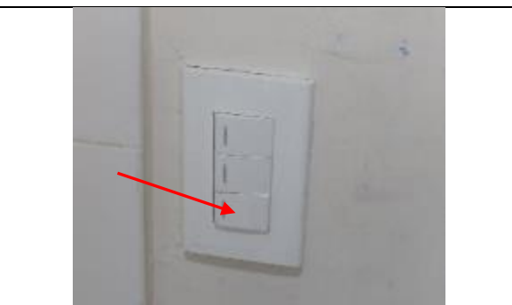
Foto No. 6: no funciona el último swich del interruptor de la luz.
