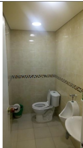
Foto No. 4 Se enchaparon los pisos y paredes de los baños y se cambiaron los aparatos sanitarios y se suministró el espejo fñlotante.
