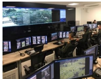
Centro de Monitoreo Existente Modernizado COSEC 3 KENNEDY Dirección: Transv 78 K Con Calle 41 D Sur Creado con el contrato 877-2017
